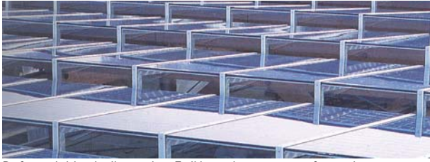
Referensbild solcellspaneler. Fjällliknande montering för att hitta gynnsam vinkel mot solen.
