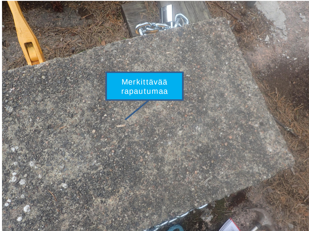
Kuva 17 Länsipään vastapainon merkittävää rapautumaa.
