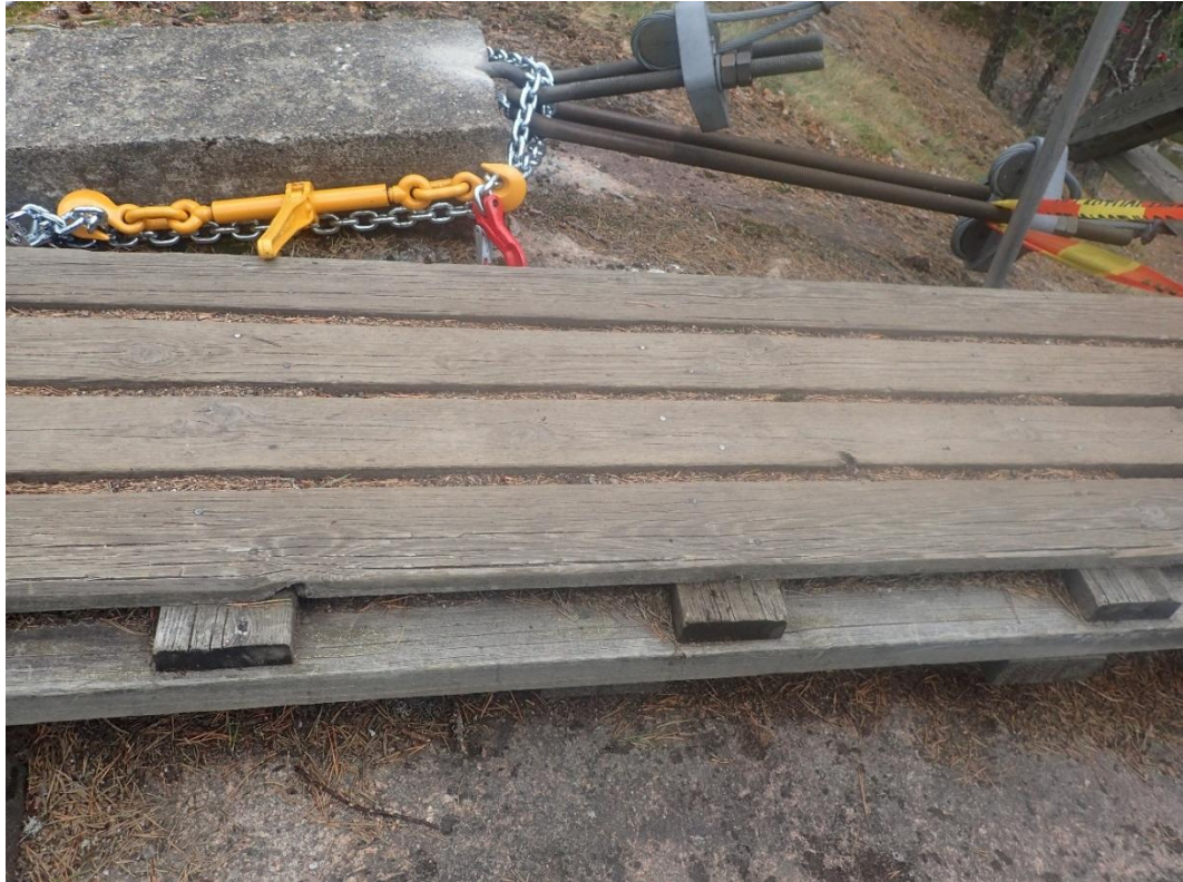
Kuva 19 Sillan puuosissa on yleisesti lievää lahoa.
