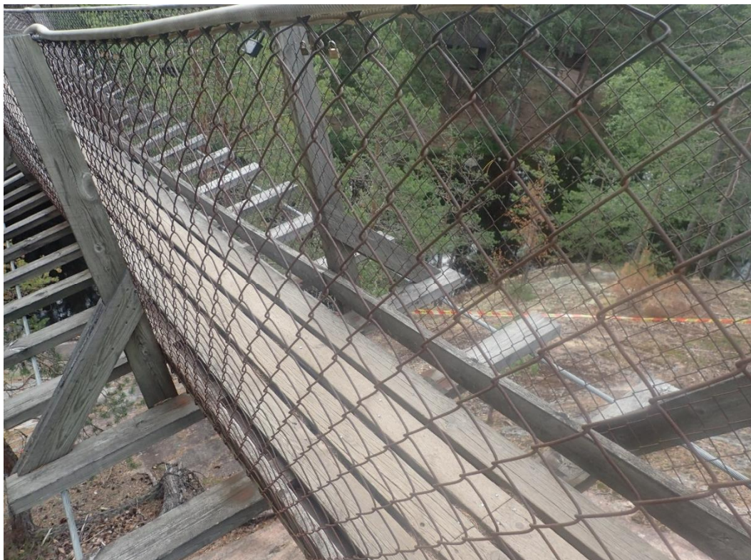
Kuva 20 Kaideverkon merkittävää ruostumista.
