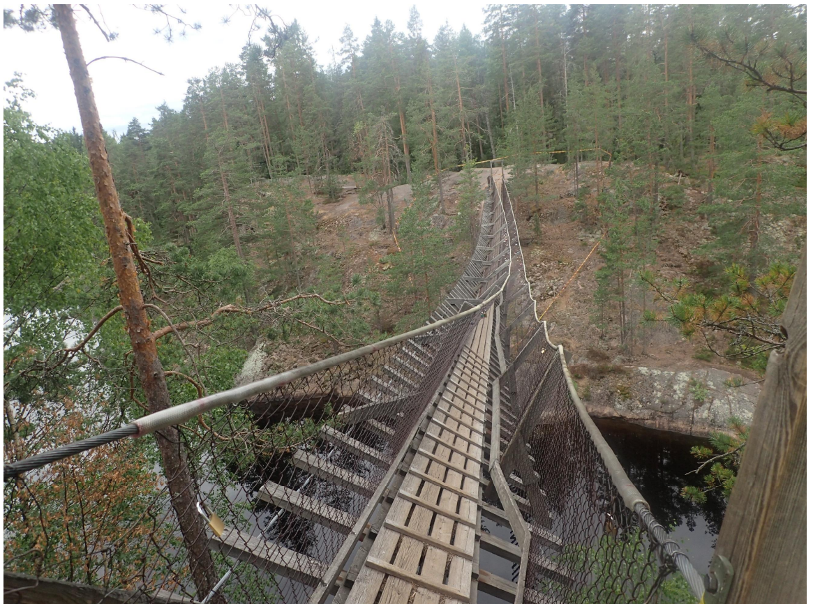
Kuva 16 Silta on osittaisen sortuman vuoksi kallistunut.
