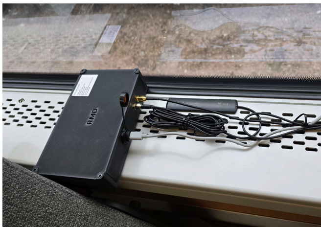
Testinstallation av PMU:C på X40
