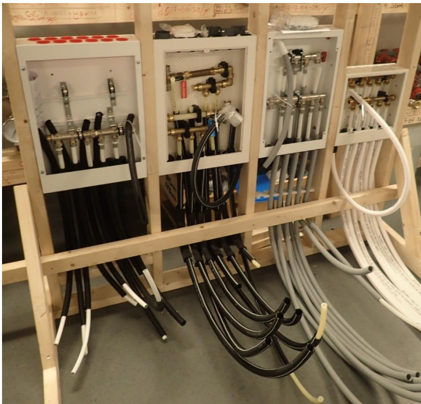
Figur 1: Fördelarskåp med monterade röranslutningar.
