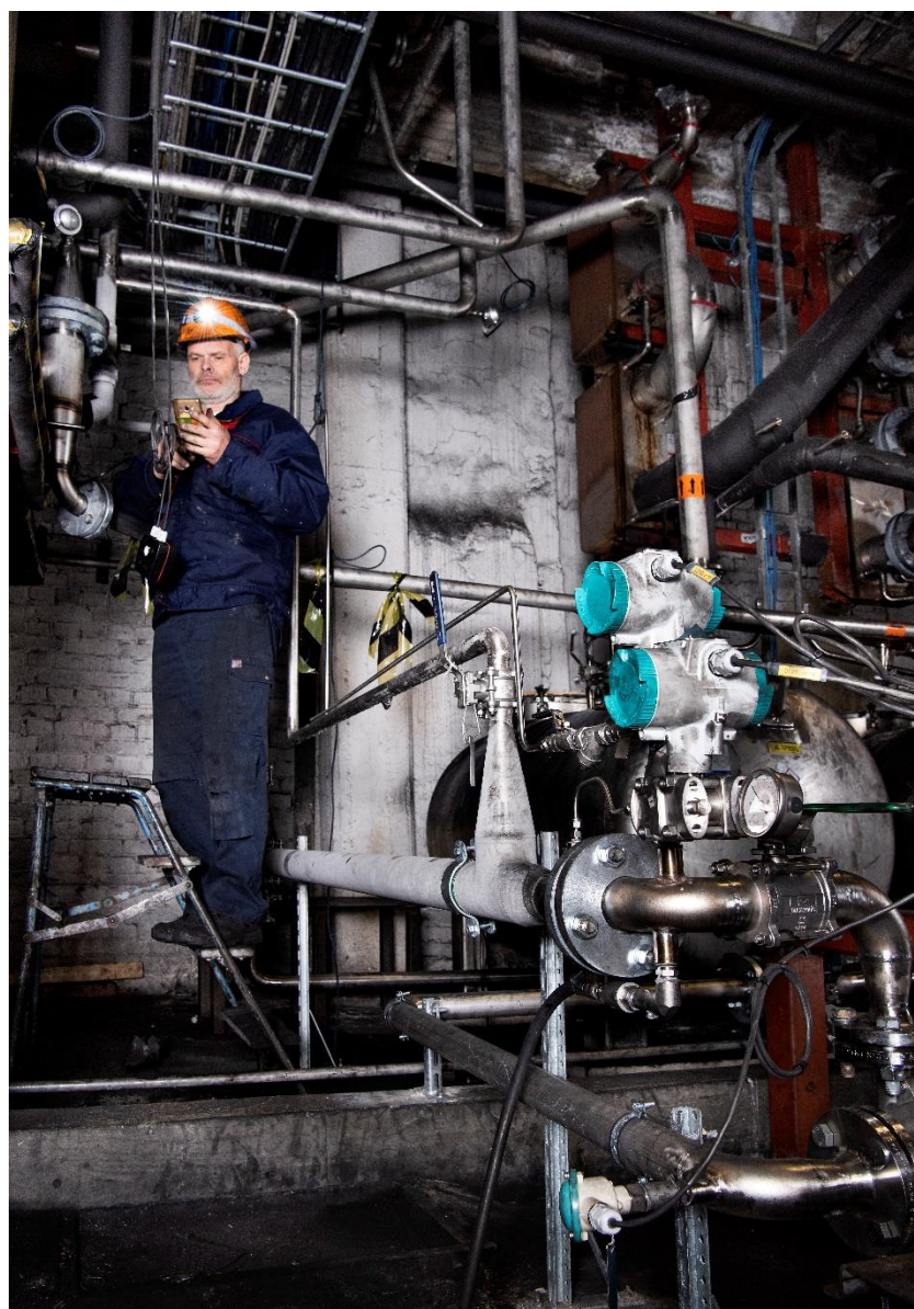
Processingenjör Carl-Johan Pihlgren utför kalibrering av en ventil till oljehanteringen i anläggningen i Åsensbruk.
