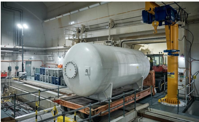
Tanken forslas ut från bergrummet inför transport från anläggningen. Foto John Guthed
