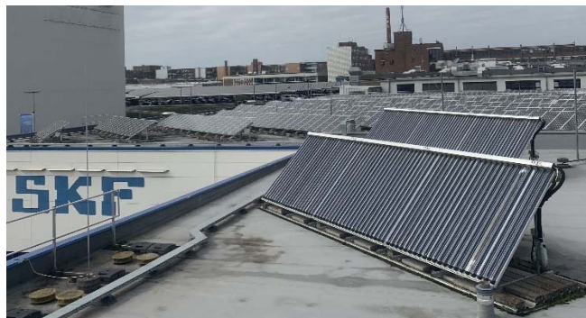
SKF Schweinfurt, Solaranlage auf der Logistikhalle.
