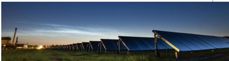
Bild från fjärrvärmeverket i Løgumkloster med solfångarpark om 15 300 m 2
