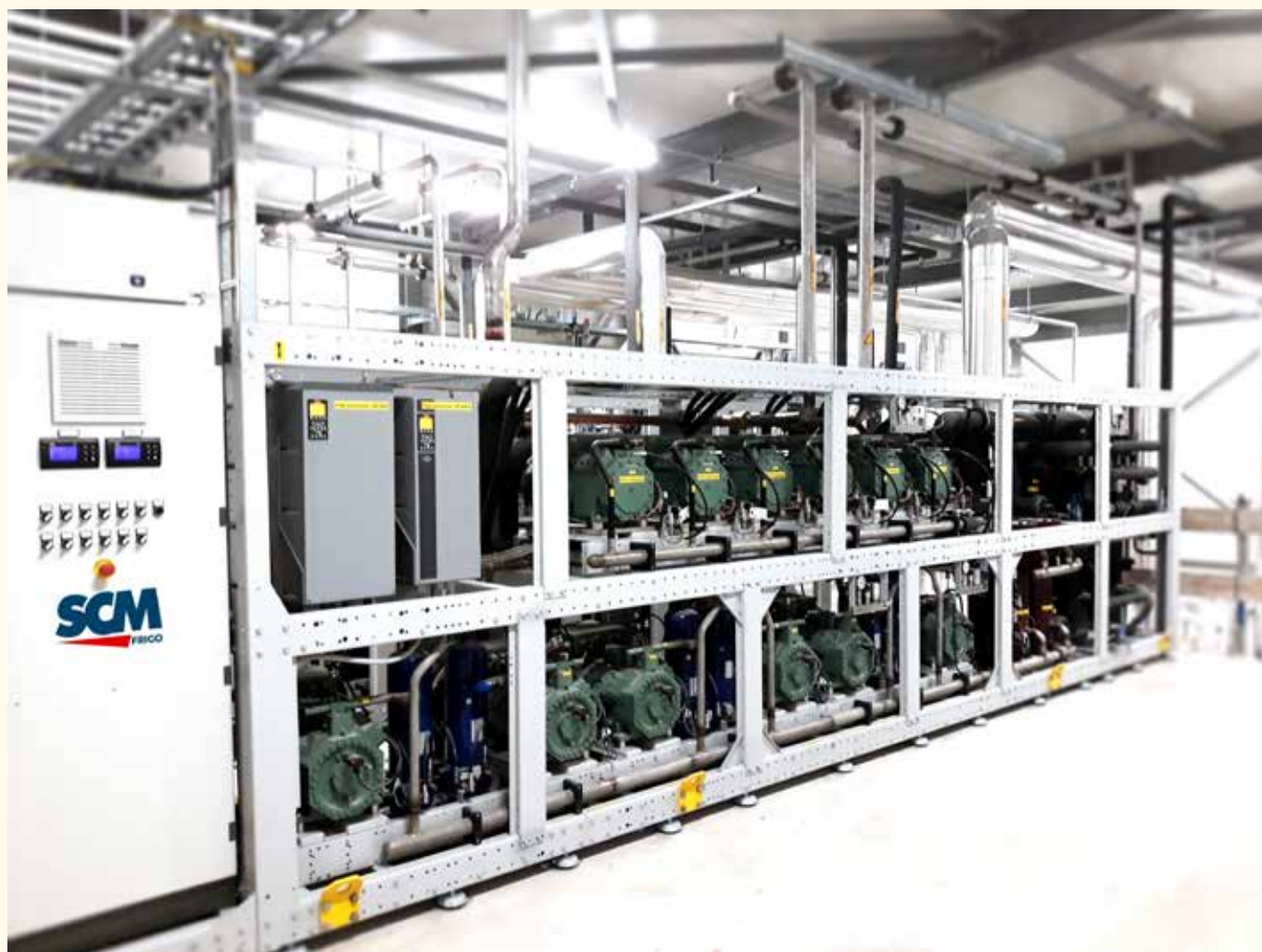
CO 2 är en hållbar lösning som kan tillämpas i många applikationer, som här i SCM Frigos booster rack (DX) vid Maître Paul's chokladfabrik i Nederländerna.
