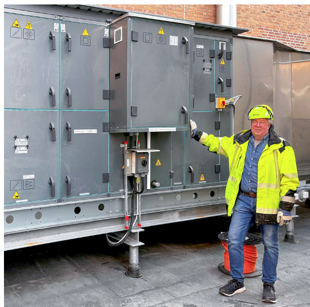
Lennart Hagelqvist, teknikansvarig hos Axolot Solutions Holding AB, vid AxoPur anläggningen som installerats hos Aspa Bruk.
