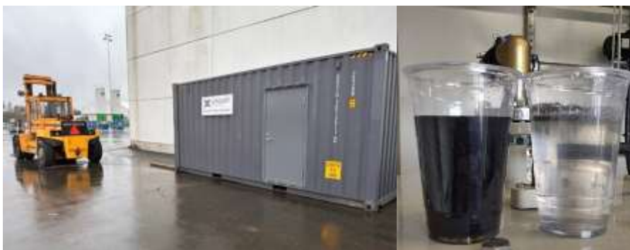
Hela AxoPur anläggningen ryms i en container
