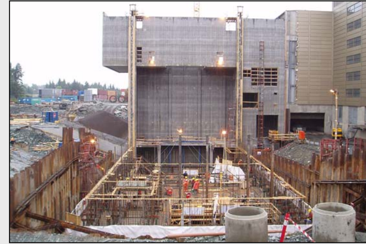
Heimdal fjernvarmesentral, Trondheim
