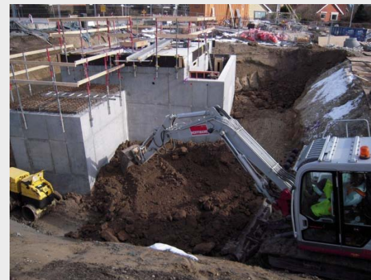
Pumpestasjon Taastrup, Danmark
