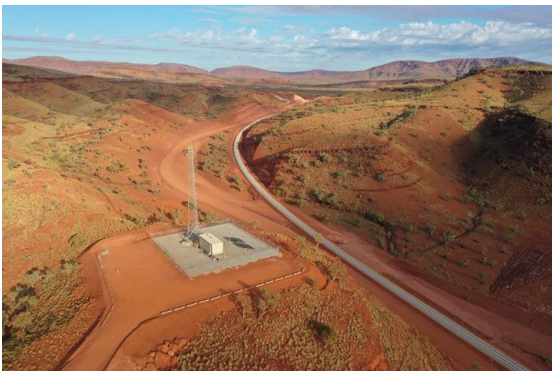
En kommunikationsnätverksplats byggd av Radlink
