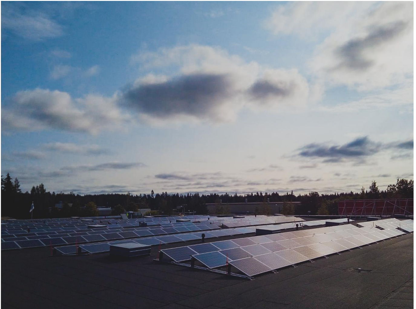
Aurinkovoimala tuottaa keskimäärin noin 10–15 prosenttia myymälän vuosittaisesta kokonaissähkönkulutuksesta. Hollolassa se on tuottanut energiaa elokuusta 2019 lähtien. Kuva: Solarigo
