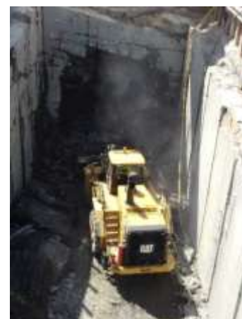
VSM är kontrakterade av Implenia att lasta ur Varbergstunneln, vilket är en del av Väst kustbanan.
