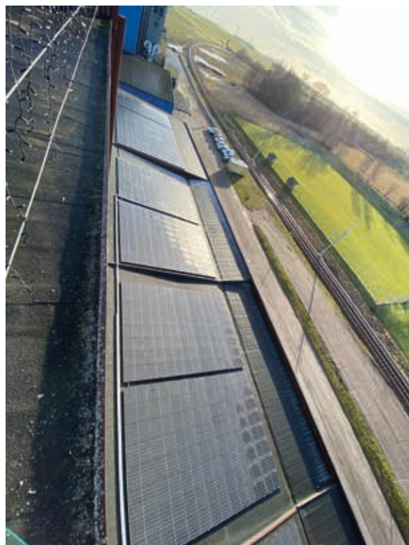
Solcellerna på vårt lagertak.
