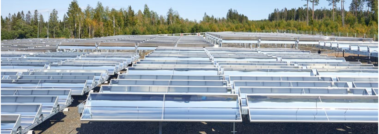
Absolicons solvärmeanläggning, Höglätten Solar Thermal Park i Härnösand.
