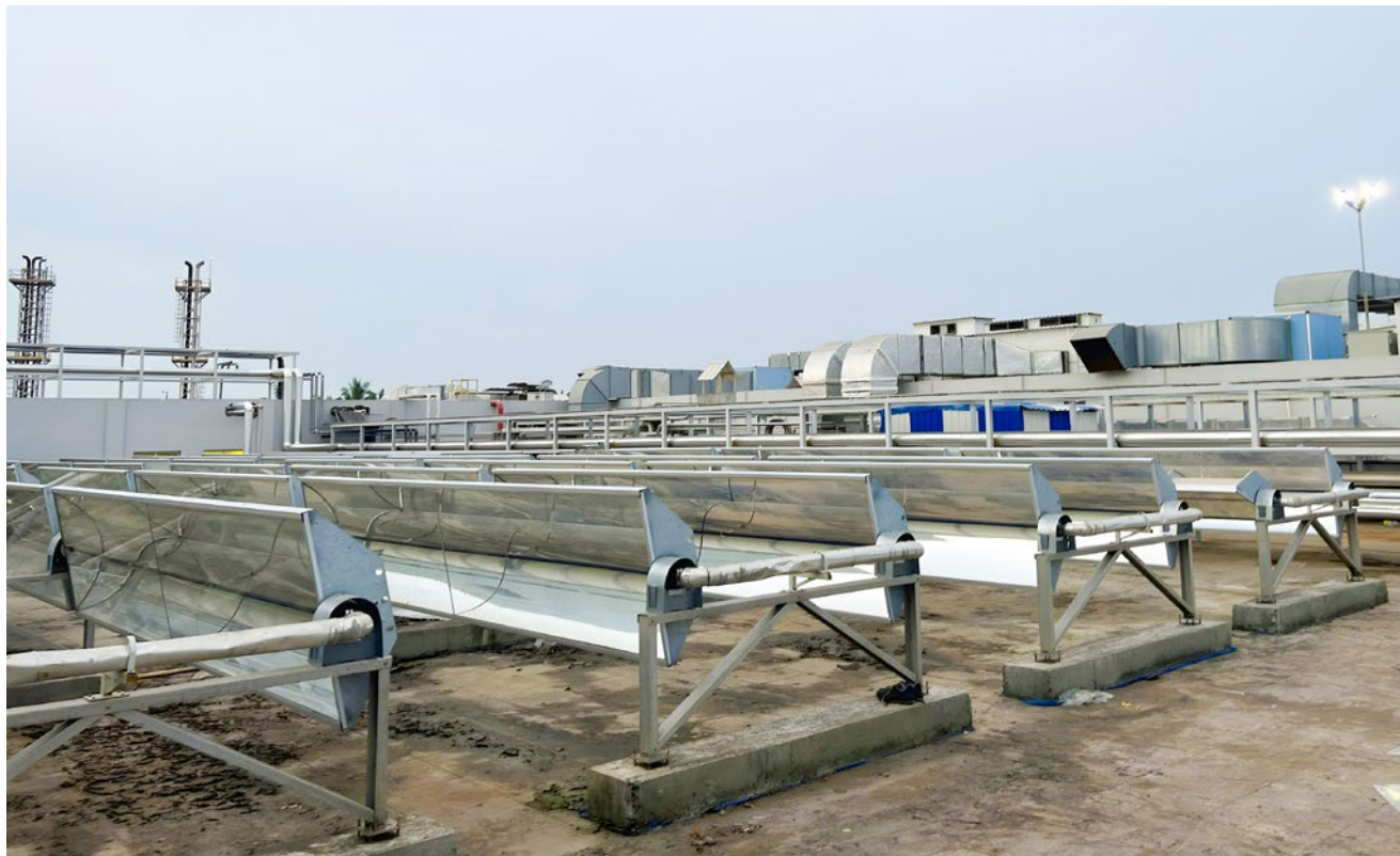
Absolicons installation av solfångare på Coca-Cola-fabrikens tak. Foto: Absolicon
