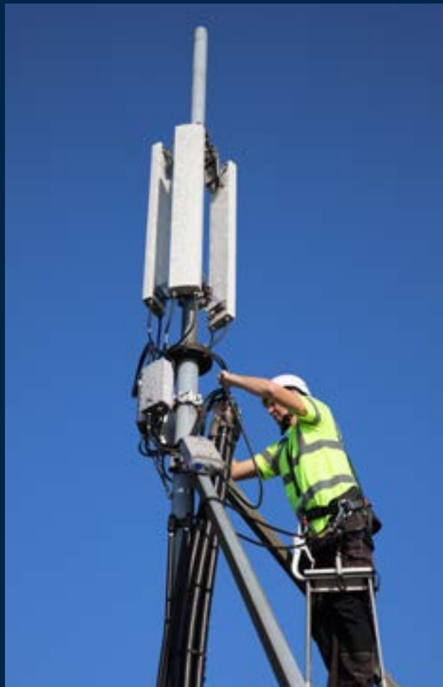
Högt upp (64 meter upp) på en silo sitter en mobiloperatörs utrustning. TNS-anställd felavhjälper.
