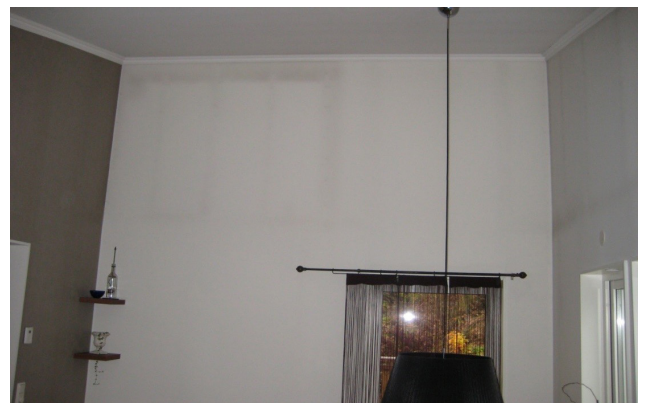
Sot i inomhusluften har fastnat på målad väggyta. Isolerbristerna framträder tydligt.
