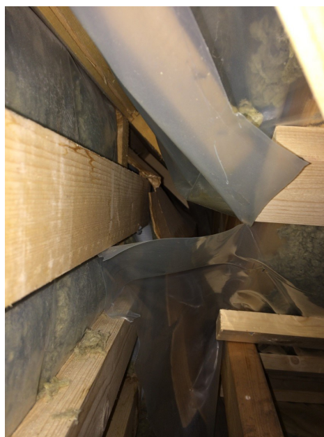
Plastfolien på övervåning med otätheter.
