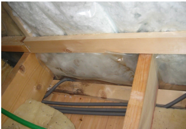
Folien uppvikt utan att ha tätats på husets övervåning. Här i mötet mellanbjälklag/yttervägg i sidovind.
