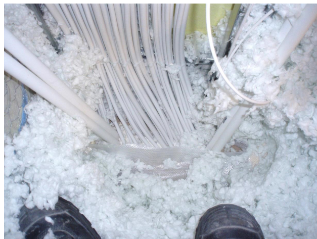
Fig 20 Exempel på en mycket otät kabelgenomföring i ett vindsbjälklag. I detta fall har man knappt försökt täta över huvud taget, men det är svårt eller omöjligt att åstadkomma helt lufttät genomföring när t.ex. många kablar eller elrör ligger bredvid varandra.
