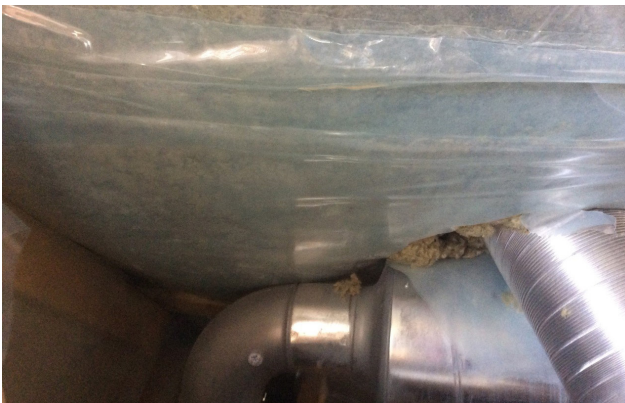
Otäthet mellan ventilationsrör och plastfolie.
