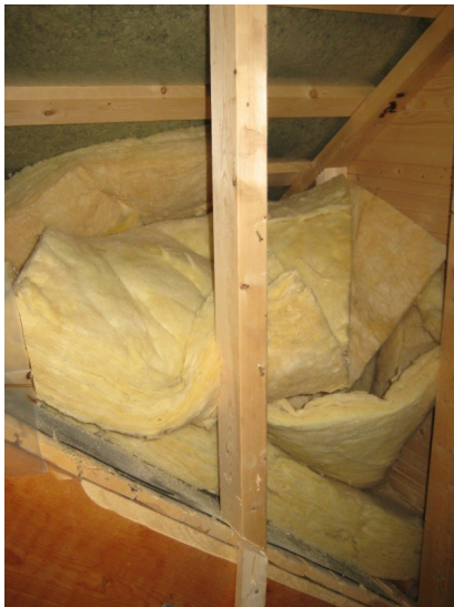
Överbliven isolering intryckt i sidovind.
