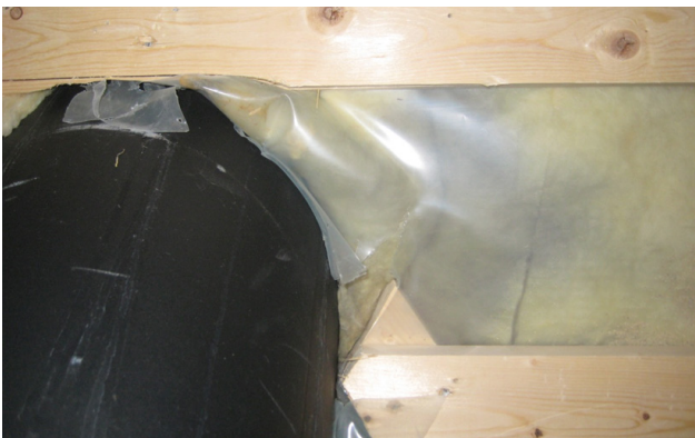
Otät anslutning av plastfolie mot skorstenrör. Fanns även tecken på att kondensvatten runnit utmed röret.
