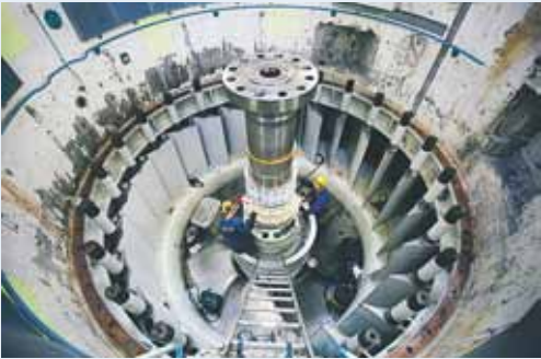
Kraftstationen i Selsfors.
