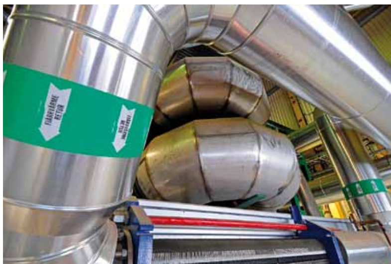
Rökgaskondensorn Renergi GK från Opcon/Svensk Rökgasenergi.
