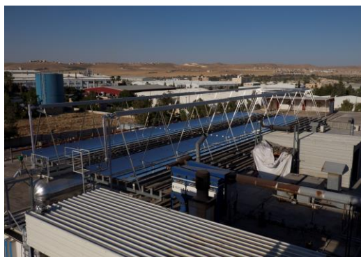
Industrial Solar kan montera sina solfångare på industritak och producera solånga för industrins processer. Installation i Jordanien.
